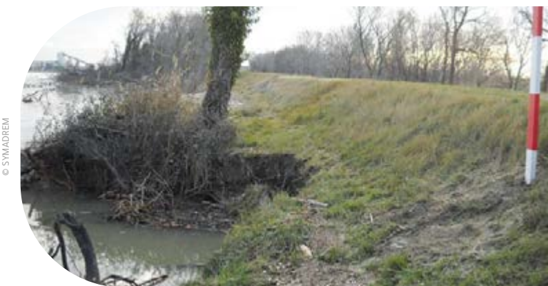
› Décembre 2010, affaissement de la digue
