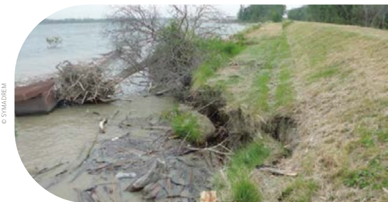
› Mai 2014, des arbres tombent et emportent une partie de la digue
