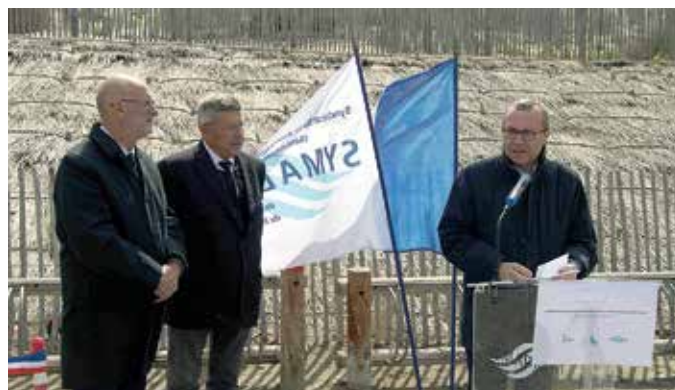
Inauguration des travaux aux Baronnetts en présence du préfet de la région Occitanie, du maire du Grau-du-Roi et du président du SYMADREM.
