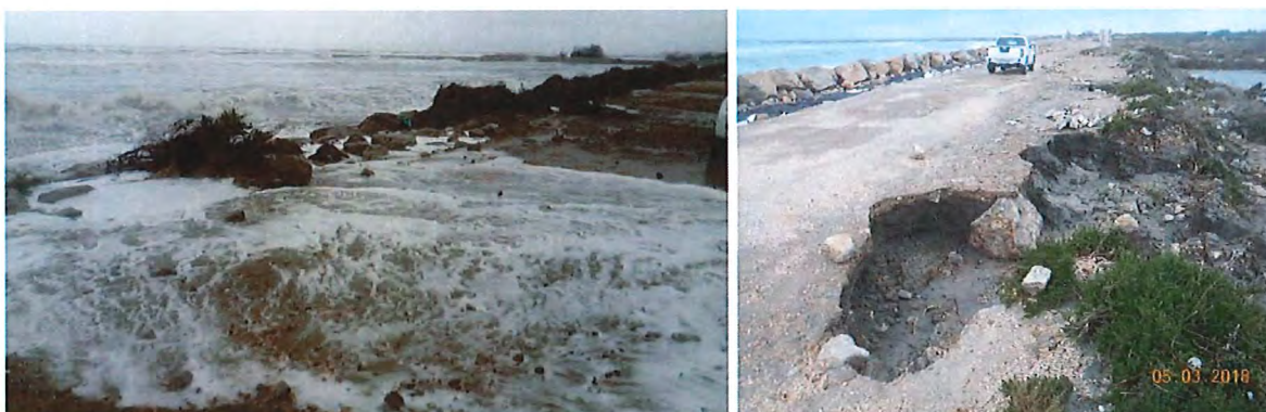
Photo 4. Déferlement de vagues et surverse sur la digue à la mer en mars 2018 (photo de gauche) – départ de brèche par surverse (photo de droite)
