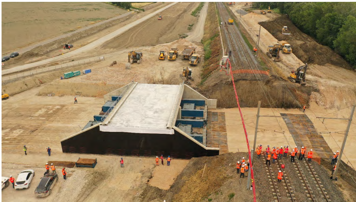
Ripage d'un ouvrage hydraulique à travers le remblai d'Arles - © SNCF Réseau – Altamétris
