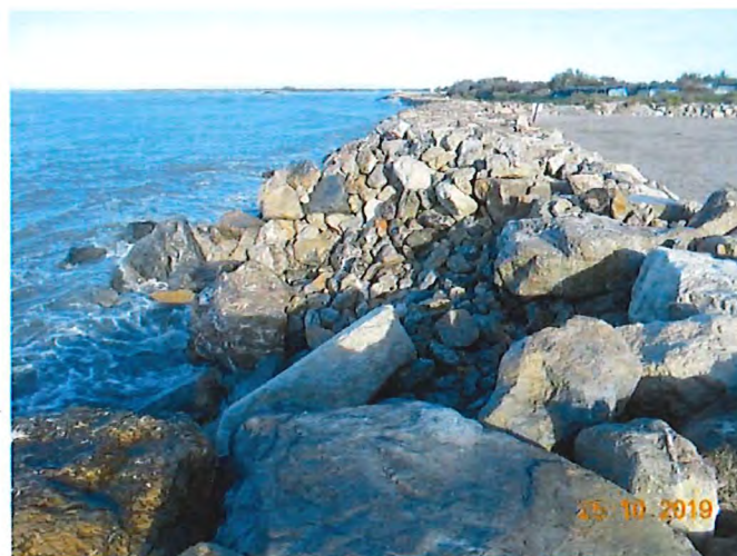
Photo 5. Rupture de l'épis tenon du clos du Rhône en octobre 2019
