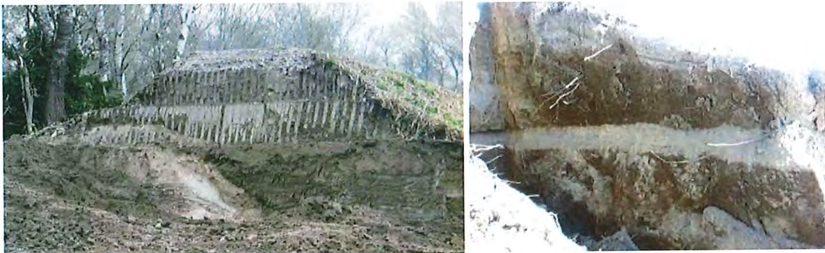
Photo 1. Digues du delta du Rhône – mille-feuilles et hétérogénéités (© Symadrem)
