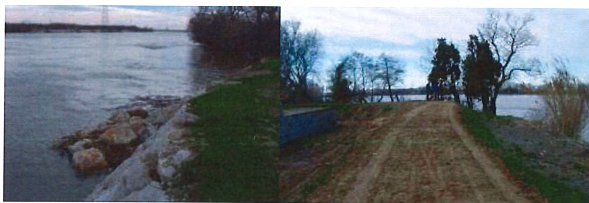
Photo 6. Pose d'enrochements côté amont (gauche) ou engraissement côté aval (droite) suite à affouillement
