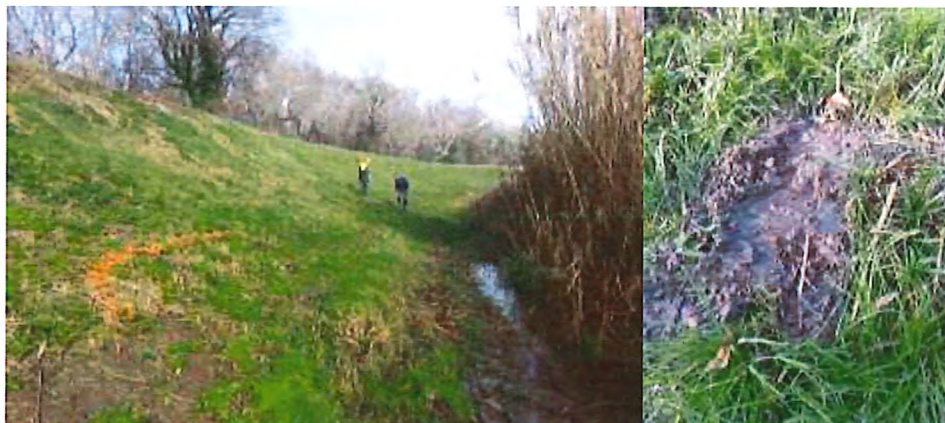
Photo 5. Infiltrations d'eaux claires
