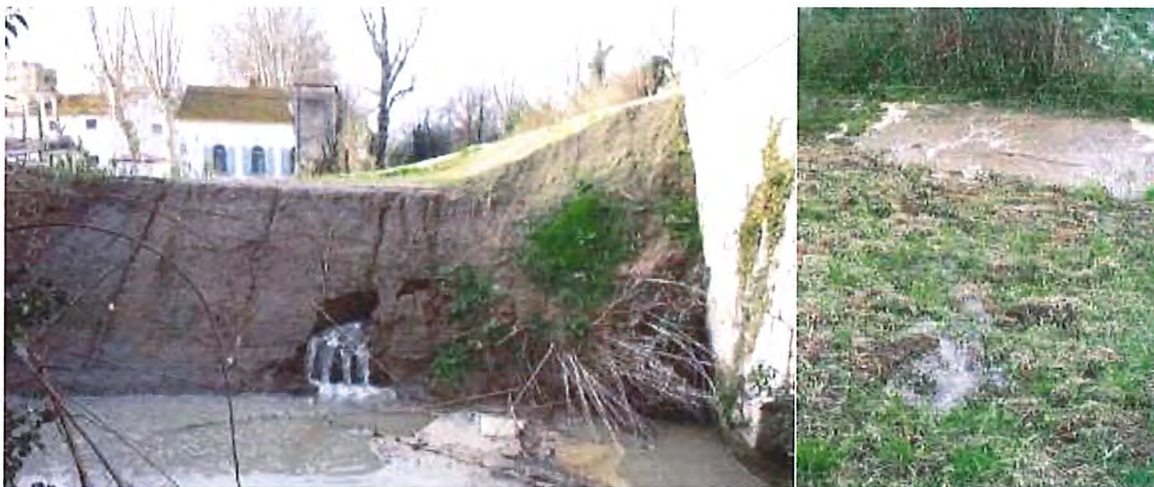
Photo 4. Fuites importantes d'eau légèrement boueuse (à gauche) et boueuse (à droite)
